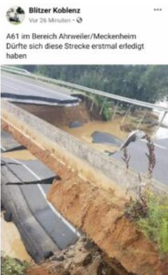
Unterspülung der A61 am 15.07.2021
